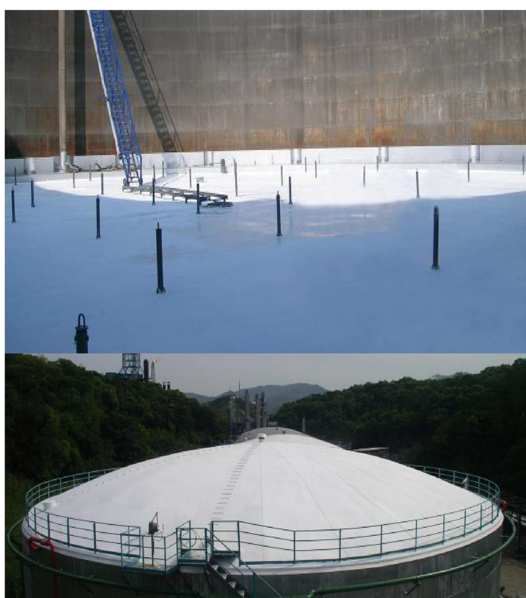
中石化**分公司 5000m 3 重油罐
